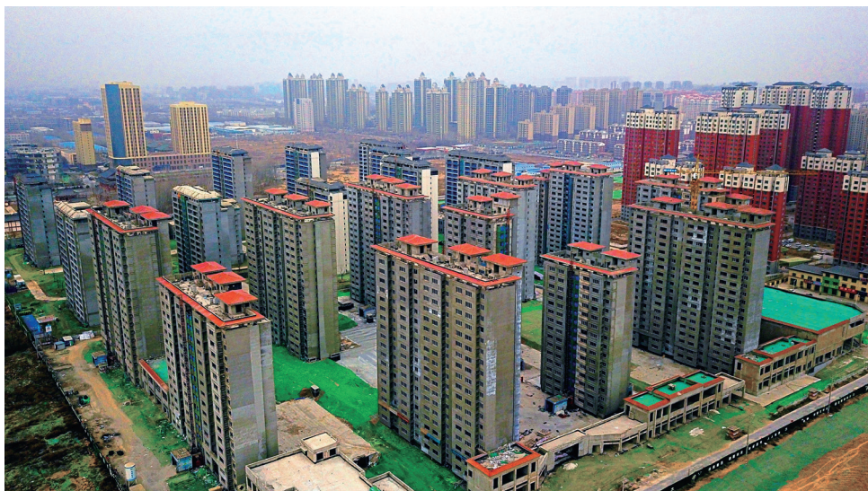
2021年12月9日，金凤区棚户区改造盈南安置区四期住宅楼实现主体封顶，该项目建成后可安置1072户居民 (苏勇 摄)
